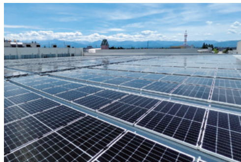
ロボット第3工場屋上に設置した太陽光パネル
