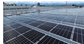
ロボット第3工場屋上の太陽光発電システム
