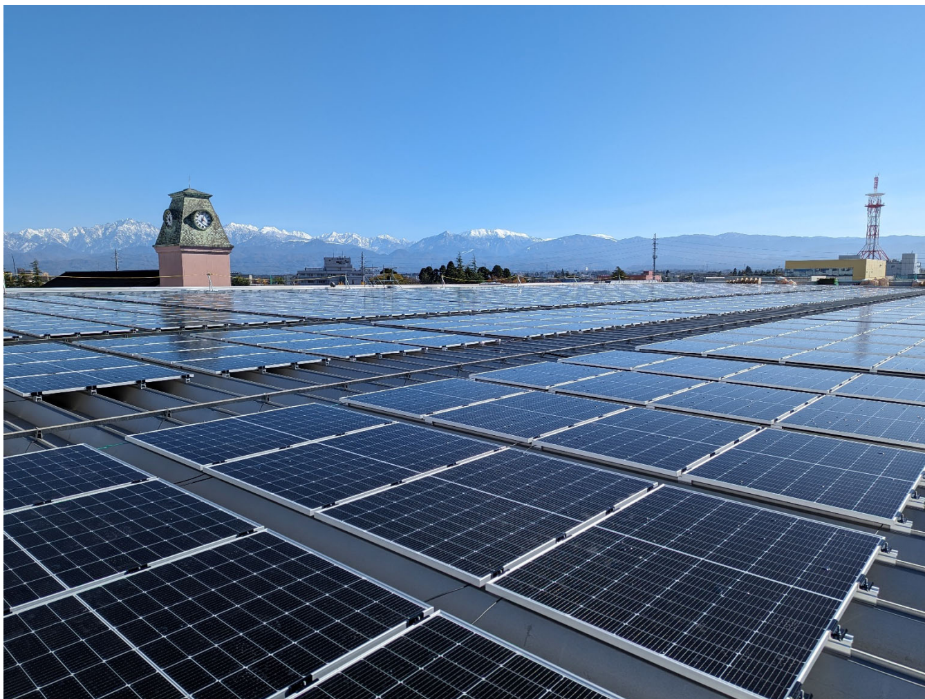
自家消費型太陽光発電システム(富山事業所 ロボット第2工場)
